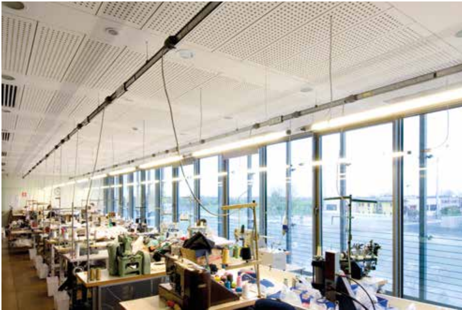
Ejemplo de iluminación y distribución de baja potencia.
